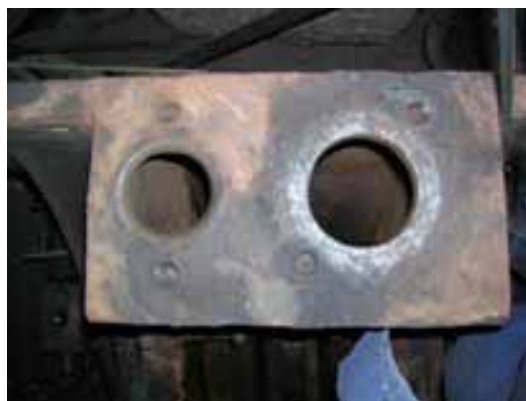
Aansluitingen stoom toe- en afvoer
