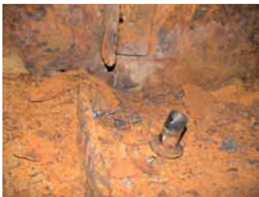
Corrosievorming binnenzijde frame, onderdeel van de waterbakken.
